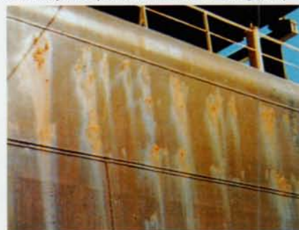
Fig. 3. Corrosiones prematuras debidas a la presencia de fragmentos de CALAMINA.
